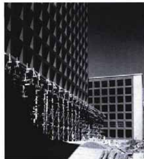
77 Al quitar los puntales y encofrados del pórtico de entrada, la fachada entera pasó a quedar colgada de la parte superior del cuerpo central.
